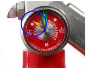
เครื่องดับเพลิง สภาพขัดข้อง (เข็มชี้ช่องแดง)
